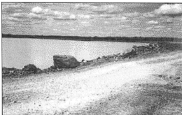
La digue qui cause problème. Cette photo a été prise en juillet. On peut remarquer que l'eau est assez élevée. Selon nos informations, ça ne fait que quelques jours que la mine n'ajoute plus de matériel contaminé dans ce bassin.
